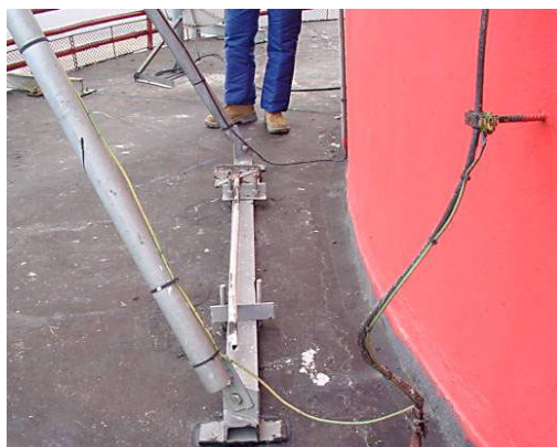
Rys. 8.10. Zbyt długa linka wyrównawcza
