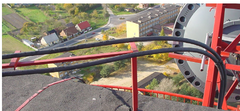
Rys. 8.2. Brak mocowania falowodów
