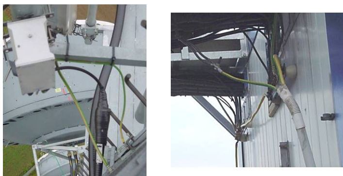
Rys. 8.9. Zbyt naprężone przewody wyrównawcze
